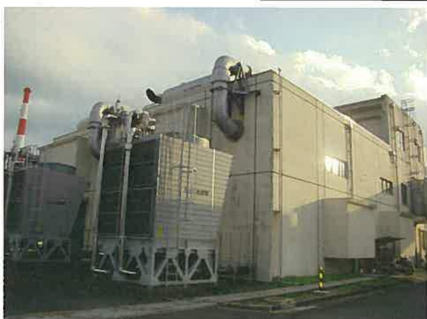
写真 29 中間開閉所・第2 中間開閉所
